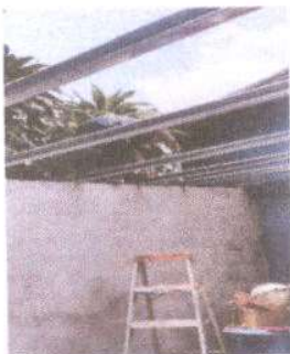
Foto 1: Lámina deteriorada. 40 M2 y estructura de madera por metal por mal estado en cocina.
