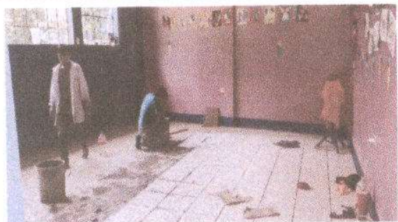
Foto 3: En aula 1, se colocará piso cerámico debido al deterioro del piso liso. Total de metros 51 m².
