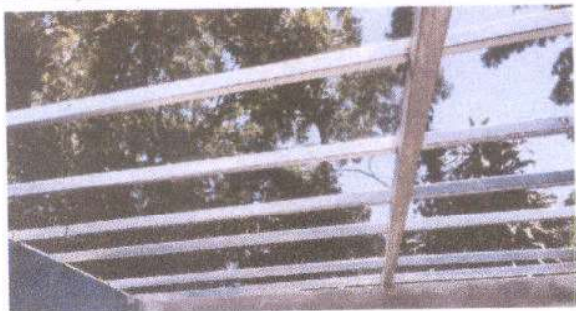
Foto 1: Cambio de laminas troquelada aluzinc calibre 26 total 15 metros. Y estructura de techo a razon que esta muy distante los durmientes o constaneras y eso permite que se unda el lienso de lamina
